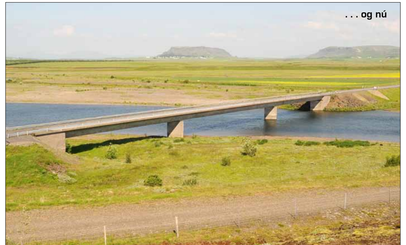
Stóra Laxá á Skeiða- og Hrunamannavegi (30). Brú frá 1985, 120 m löng. Hún er einbreið sem er óheppilegt á þessum stað. Skoðaðir hafa verið möguleikar á breikkun eða endurnýjun en ekki er komin niðurstaða í það mál. Þessi brú er um 100 m neðar í farveginum en gamla brúin og sjónarhorn myndanna því ekki alveg það sama. Neðst á myndinni má sjá leyfar vegarins að gamla brúarstæðinu.
